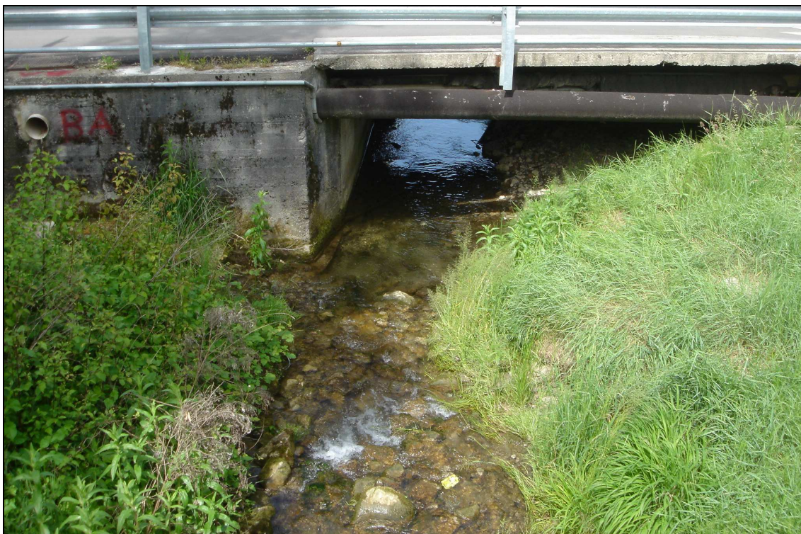
Fig. 16 - sezione critica dell'attraversamento del torrente Rino, intersezione via Stadio e via Stelvio, da monte verso valle (immagine 2007)
