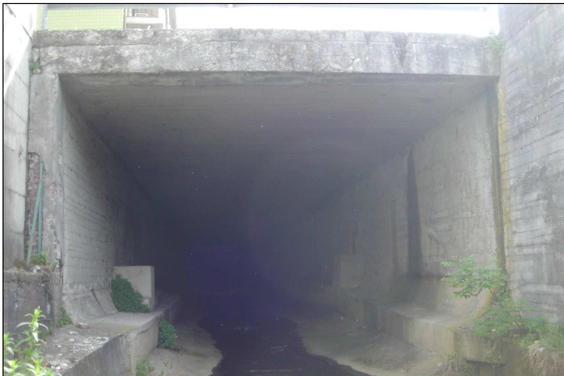
Fig. 27 – sezione di valle del tratto del torrente Rino tombottato in corrispondenza di via Brennero
