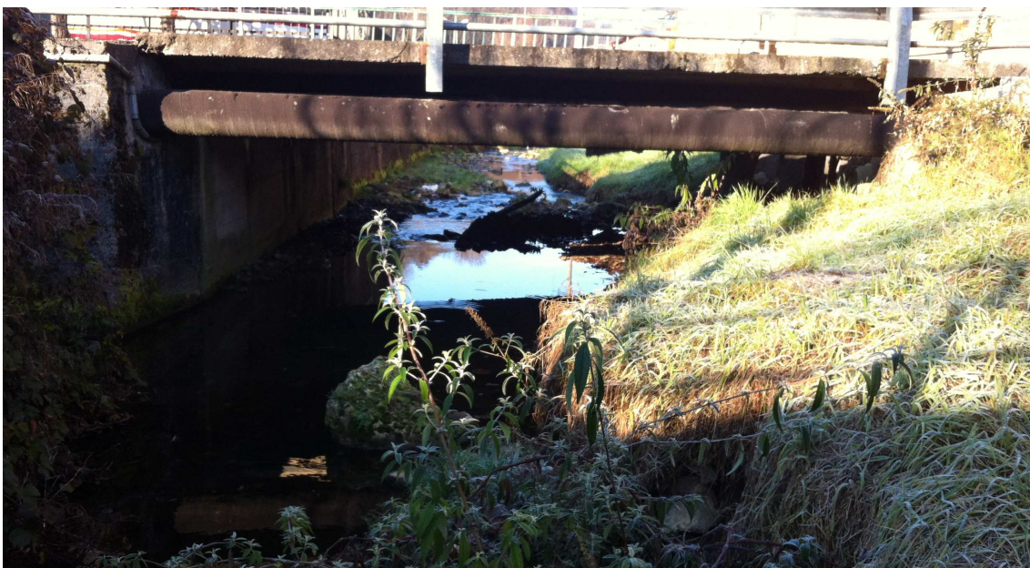
Fig. 17 - sezione critica dell'attraversamento del torrente Rino, intersezione via Stadio e via Stelvio, da monte verso valle (immagine 2016)
