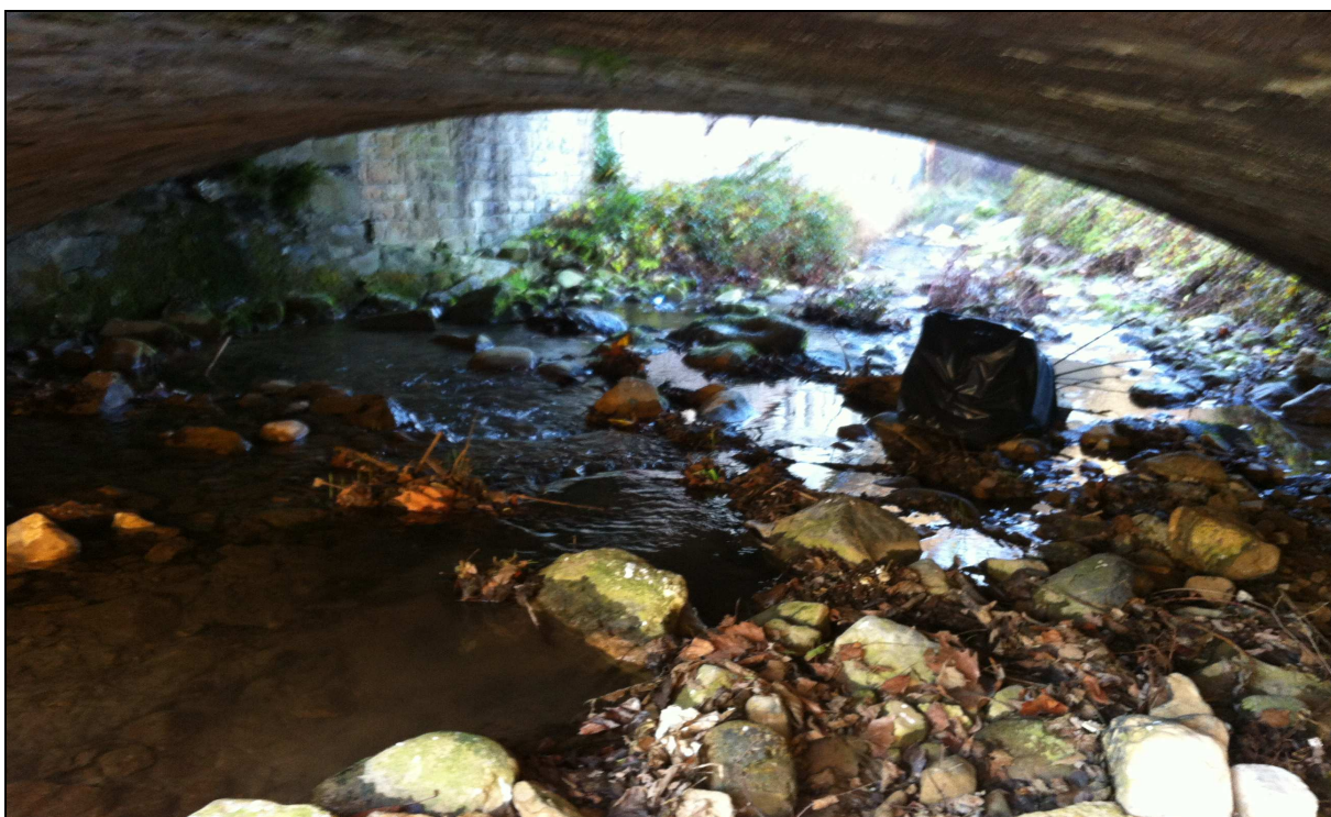
Fig. 15 - depositi alluvionali e materiale scarico sotto il ponte di attraversamento della ditta Warmor
