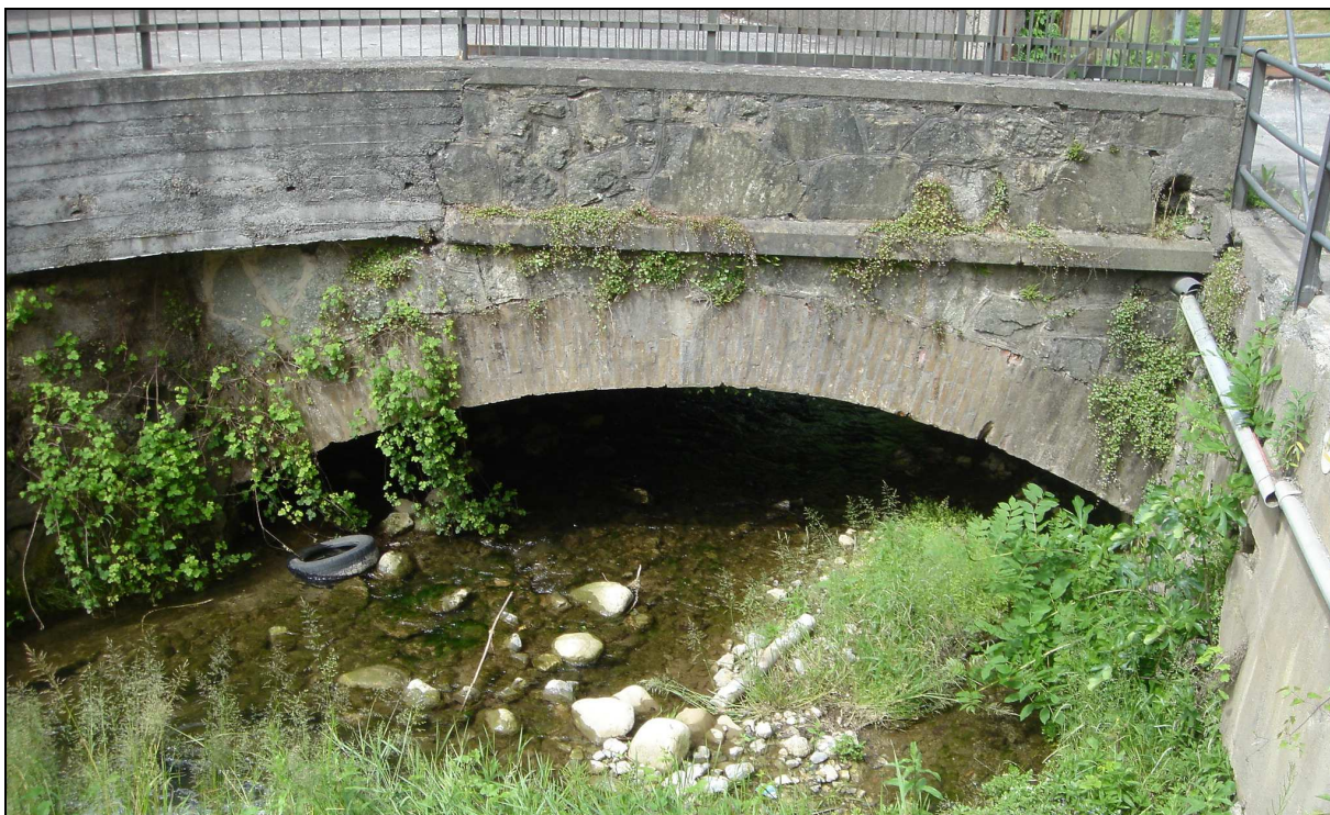
Fig. 14 - sezione di monte critica dell'attraversamento del Torrente Rino presso la ditta Warmor in via Stadio
