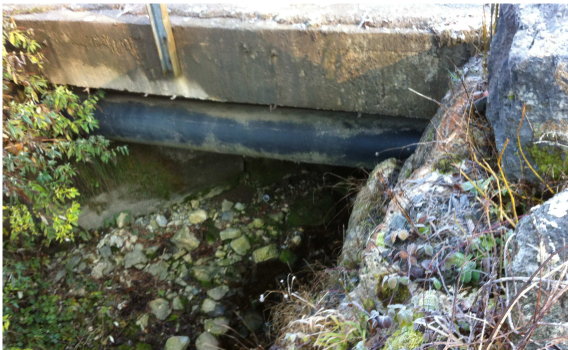
Fig. 20 - sezione di valle critica dell'attraversamento del torrente Rino, tratto di via Stadio a monte dello stadio "Martinelli"
