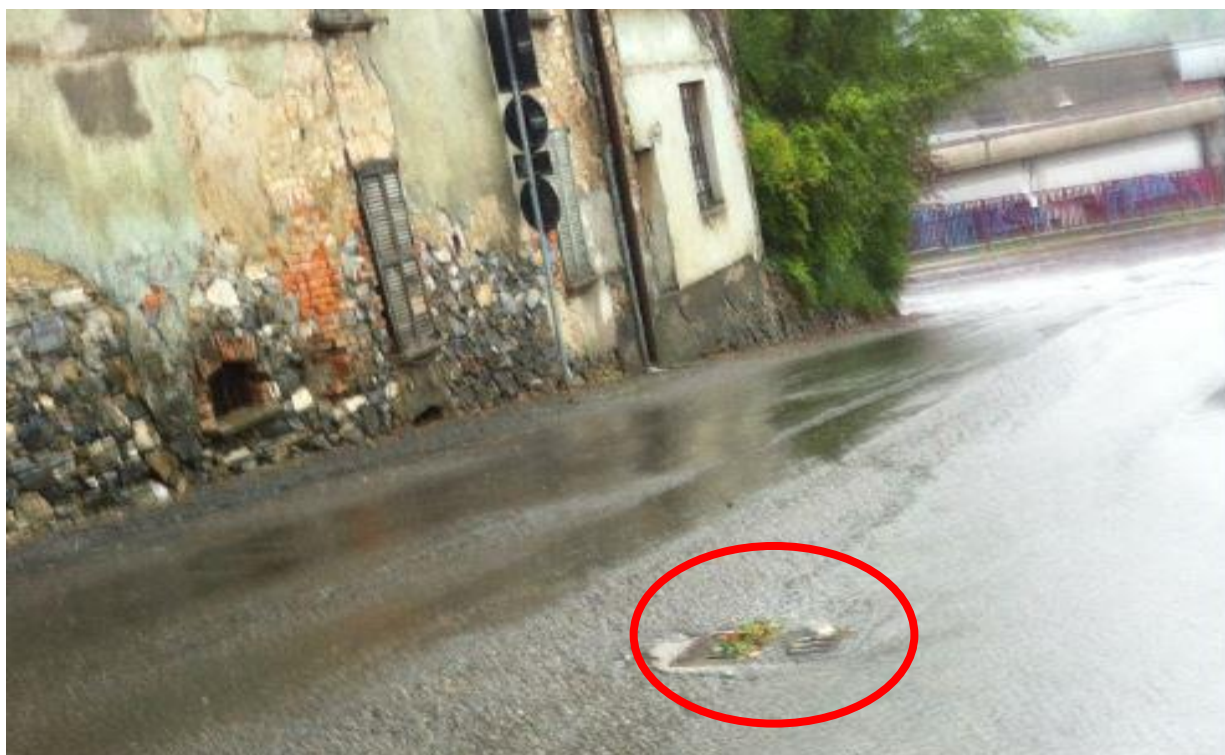
Fig. 38 – ruscellamenti lungo la strada che da via Manzoni di Gandino conduce verso Leffe e fuoriuscita degli apporti fognari dalle caditoie in corrispondenza di eventi meteorici intensi di agosto 2016
