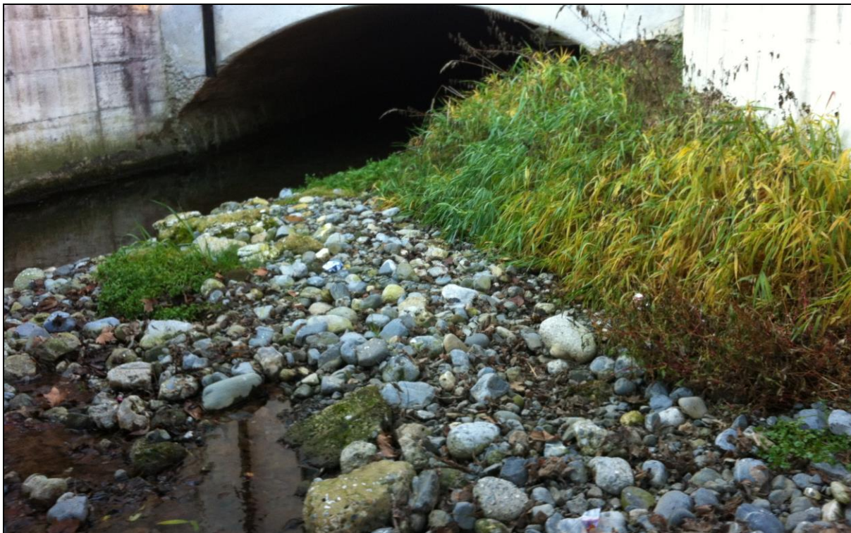
Fig. 27 - sezione di monte del tombotto di via Piave parzialmente ostruita da una barra alluvionale
