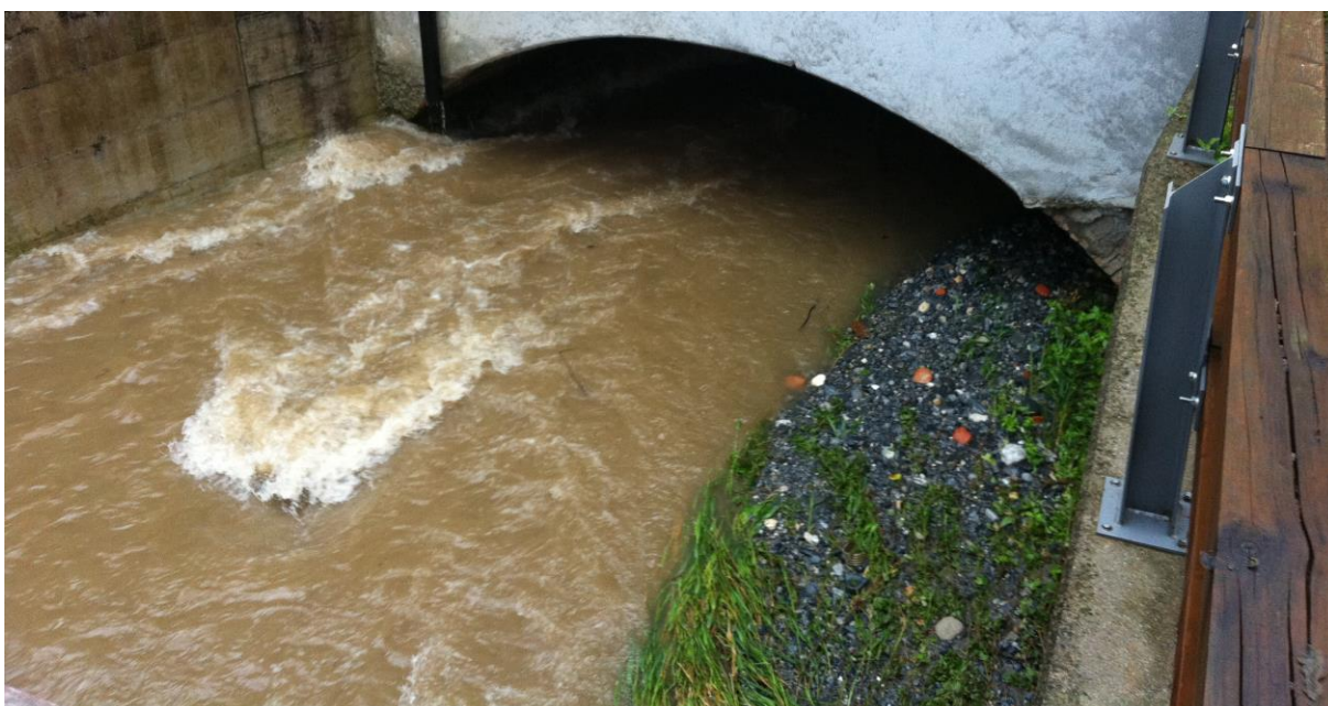
Fig. 31 – Torrente Romna durante una precipitazione ordinaria nel luglio 2014 in corrispondenza dell’imbocco del tratto tombottato di via Piave
