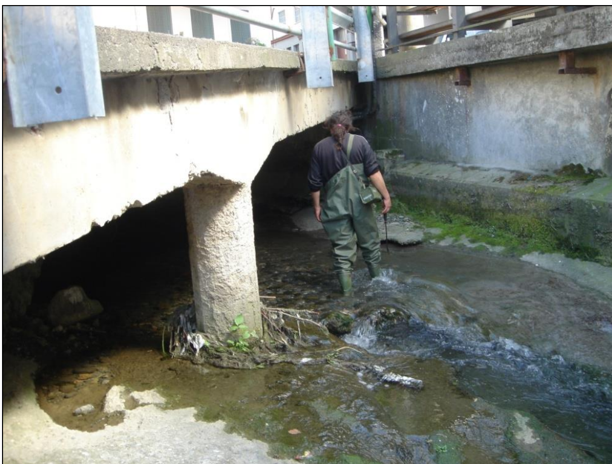
Fig. 25 - sezione critica del torrente Romna in corrispondenza di via Piave, zona ex Bergitex
