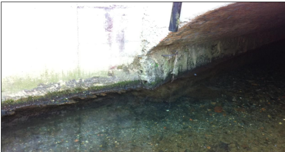
Fig. 28 - dettaglio dei fenomeni erosivi di scalzamento delle opere murarie all'imbocco del tombotto di via Piave
