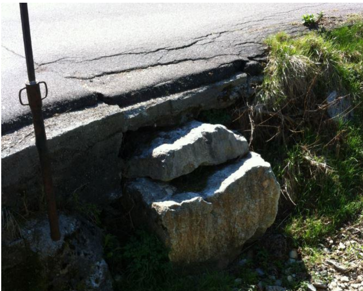
Fig. 73c– scalzamento della massicciata di arginatura lungo la Valbrugali in via Fontanone - Lefte
