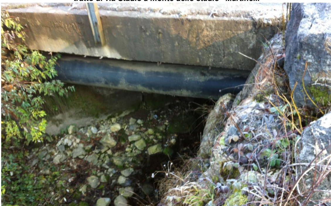
Fig. 48 - sezione di valle critica dell'attraversamento del torrente Rino, tratto di via Stadio a monte dello stadio "Martinelli"
