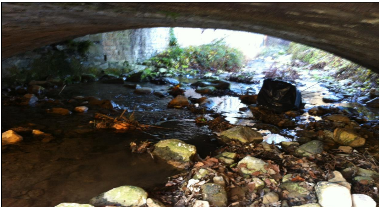
Fig. 41e - depositi alluvionali e materiale scarico sotto il ponte di attraversamento della ditta Warmor
