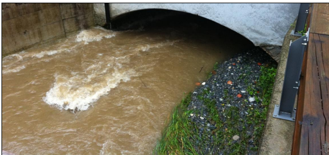
Fig. 32 – Torrente Romna durante una precipitazione ordinaria nel luglio 2014 in corrispondenza dell’imbocco del tratto tombottato di via Piave
