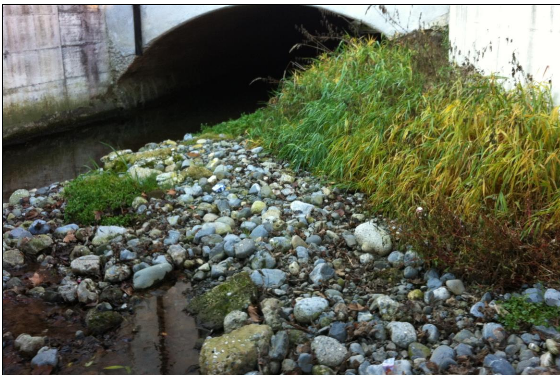
Fig. 29a - sezione di monte del tombotto di via Piave parzialmente ostruita da una barra alluvionale
