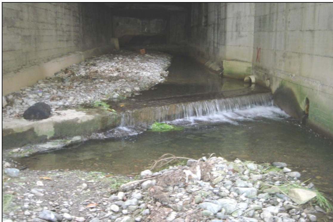
Fig. 53 – sezione di valle del tratto del torrente Rino tombottato in corrispondenza di via Tonale
