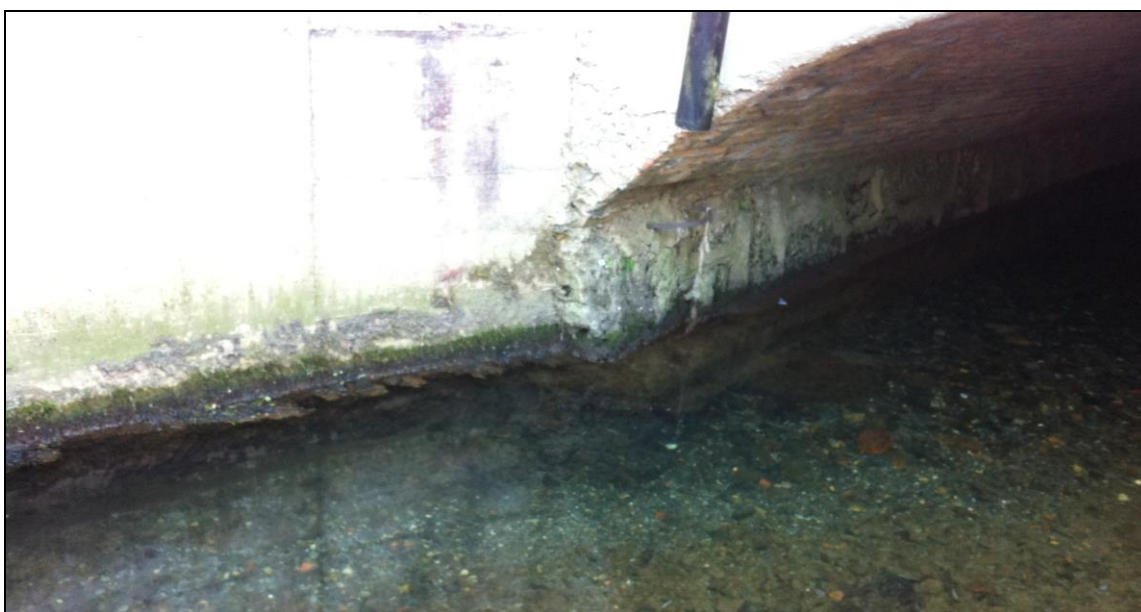
Fig. 29b - dettaglio dei fenomeni erosivi di scalzamento delle opere murarie all'imbocco del tombotto di via Piave
