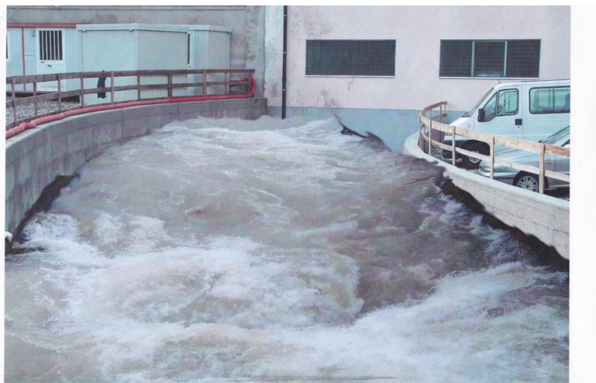
Fig. 63 – fotosimulazione di condizioni di criticità : soglia critica 2 - emergenza (ingresso tombotto di monte di via Piave), documentazione archivi comunali (U.T.)
