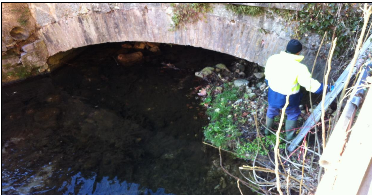
Fig. 41a - sezione di monte critica del ponte di attraversamento carrabile del Torrente Rino presso la ditta Warmor in via Stadio
